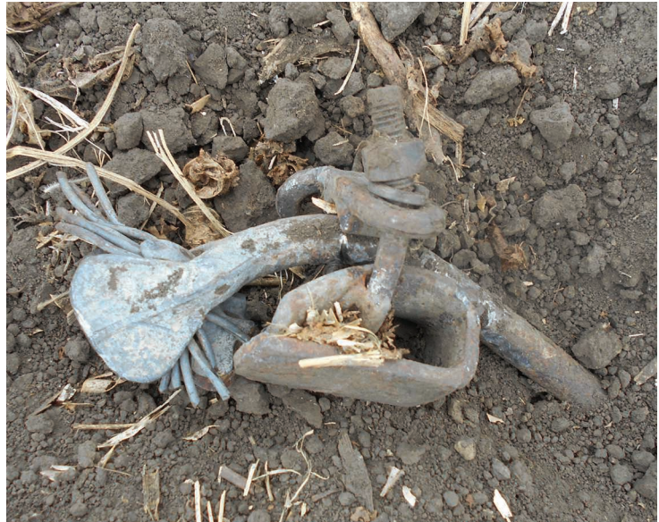
Guy wire bolt
